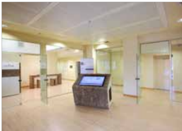
Realización con techos radiantes metálicos
